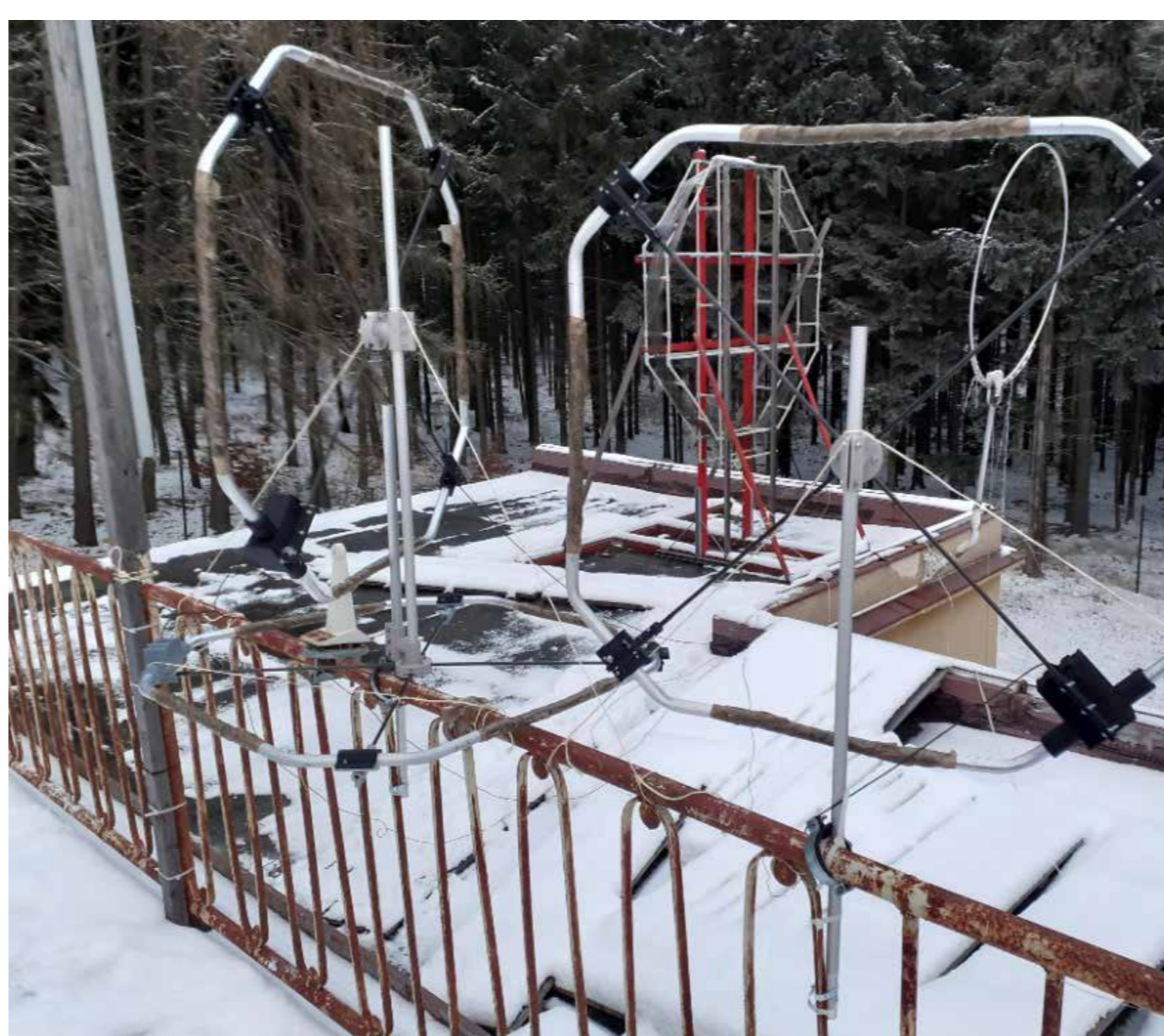
Antény měřících stanic na střeše hvězdárny.
